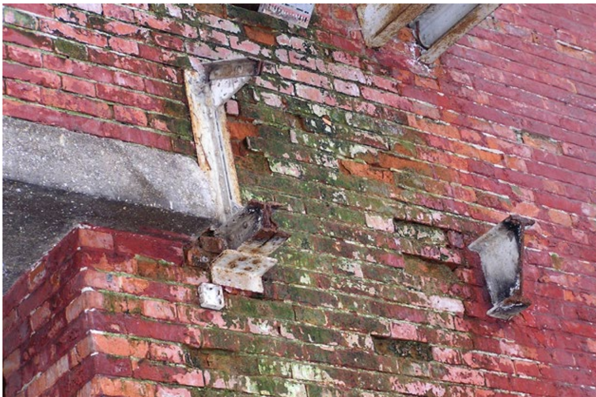
SLIKA 017 Detalj zida s oštećenim konstrukcijskim elementima, 2014. / IMAGE 017 Detail of wall with damaged structural elements, 2014
