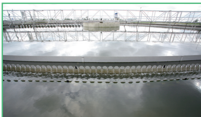
BAZEN u koji se izliva pročišćena otpadna voda koja se nakon postupka gotovo može piti
